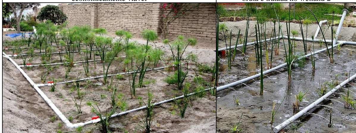
Figura 7 e 8: Wetlands para tratamento de águas negras (esquerda) e cinzas (direta) de fluxo vertical, antes de ser completado com uma chamada de brita na superfície, tubos de distribuição de wetland de água negra equipados com registros, para poder deixar descansar as áreas afetadas por perigo de colmatacao
