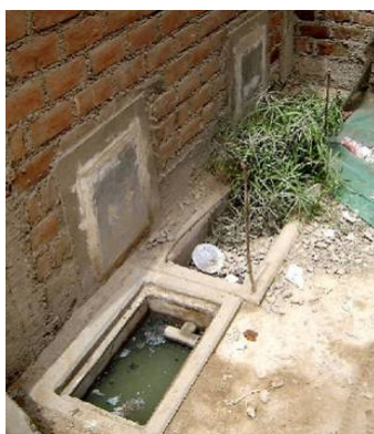
Figura 2: Hasta el 2007, UDDT en Lima mezclaron siempre las aguas grises con orina, la infiltración no trabajó a menudo correctamente Fuente: P. Oswald
