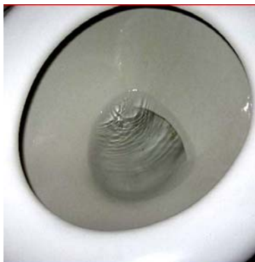
Figura 7: Pérdida de agua por mal funcionamiento de válvula de agua Fuente: H. Hoffmann
